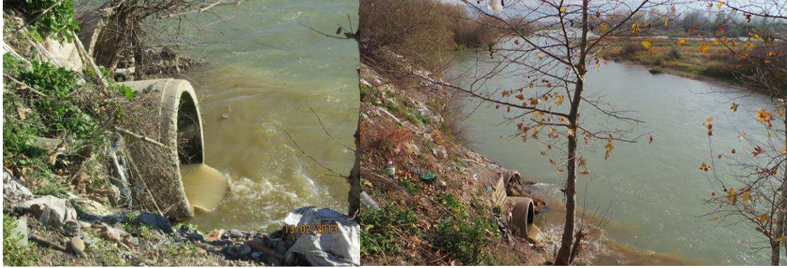
Şekil 2: 1000 mm çaplı borudan Kelkit Çayı'na atıksu deşarjı
